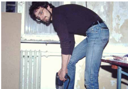
Jugendarbeit im wahrsten Sinne des Wortes: beim Umbau eines alten Kellers zum ersten Wipperfürther Jugendzentrum (1983)
